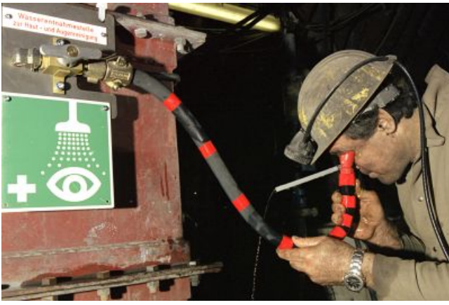
Augenspülstation untertage im Einsatz
